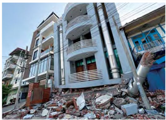
緬甸地震後樓宇倒塌損毀
